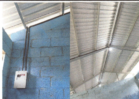
Foto 5.Módulo 3: Interior de la instalación eléctrica, realizada en cuatro módulos de aulas.
