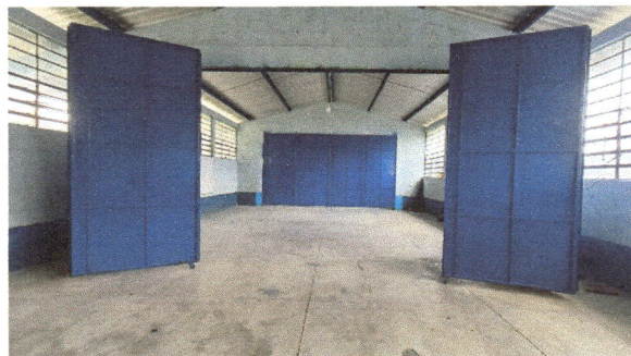
Foto 8. Módulo 5: Sustitución de panel divisor de aulas de madera por metal. Vista general de módulos divisores metálicos. Ambos se encuentran instalados correctamente y en funcionamiento.
